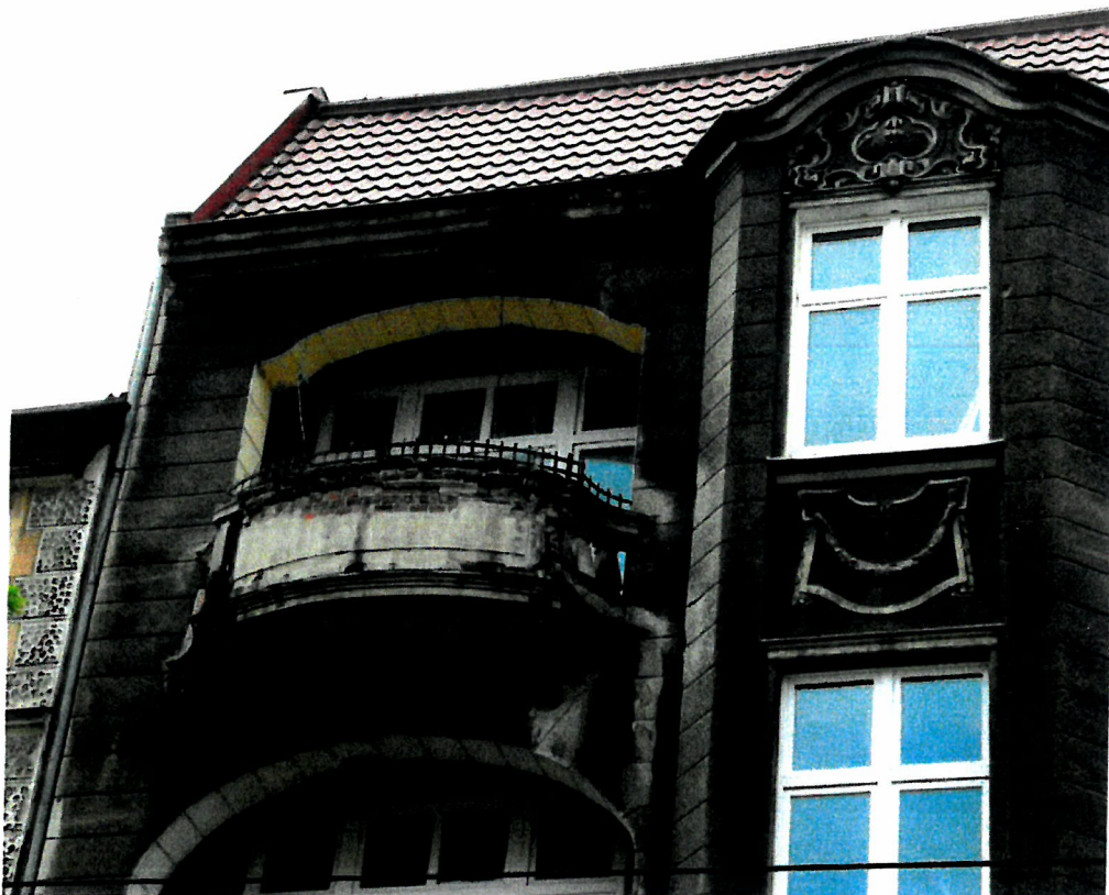
Fot. 7 Fragment elewacji – widoczne uszkodzenia balustrady balkonu
