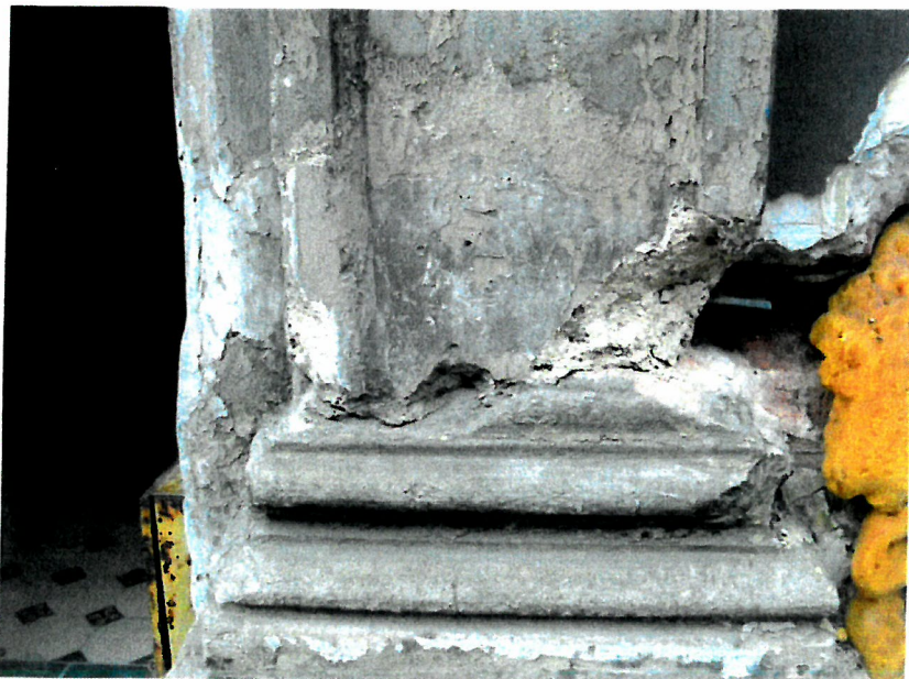
Fot.12 Fragment portalu – uszkodzenia w dolnej partii
