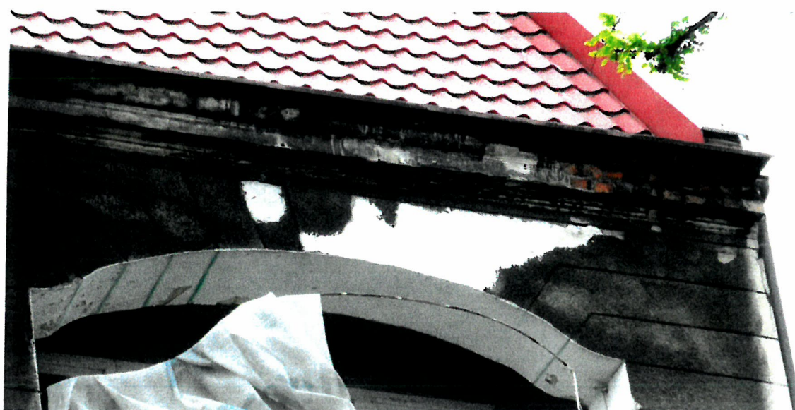
Fot. 10 Uszkodzenia gzymsu wieńczącego
