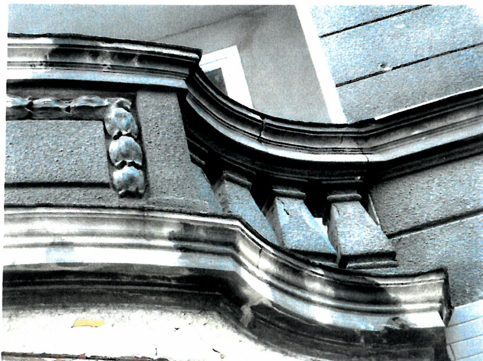
Fot.8 Fragment balkonu – na tralkach widoczne odspajanie się tynku nakrapianego, położonego wtórnice
