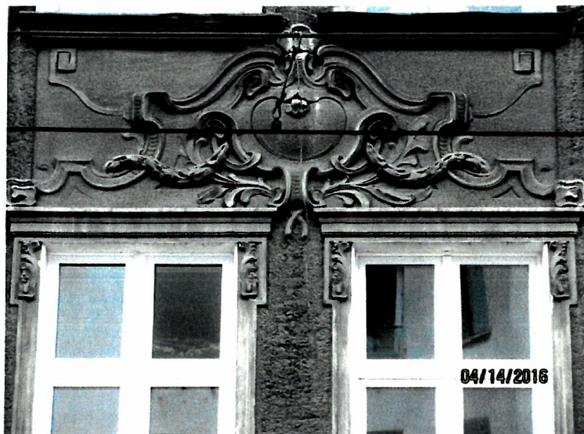
Rys. 14 Zdobienia sztukatorskie nad oknami na 1 piętrze, należy usunąć wtórny tynk nakrapiany, szczegół – pozycja nr 2, źródło własne
