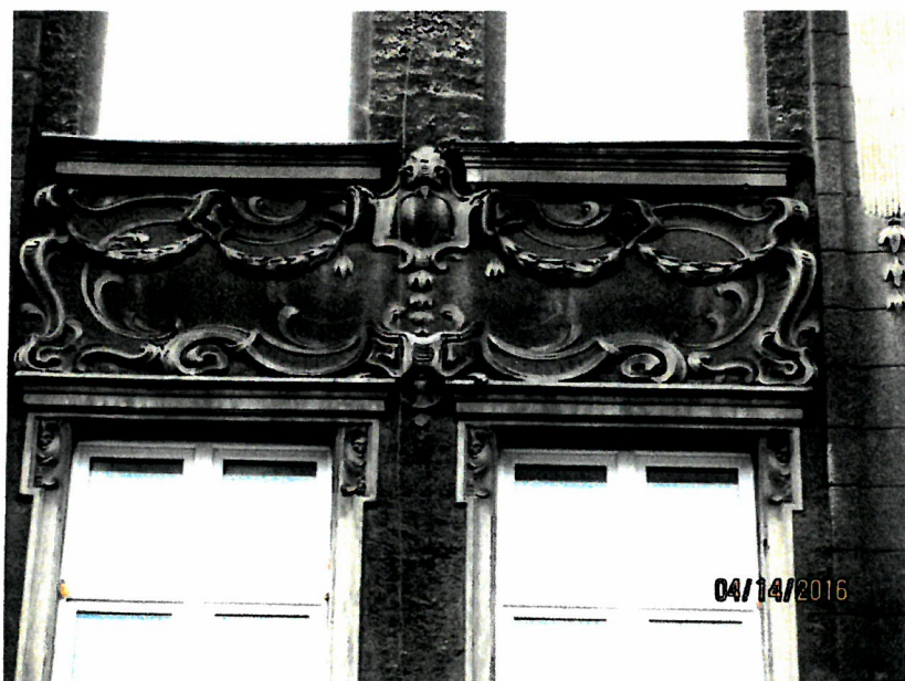
Rys. 15 Zdobienia sztukatorskie nad oknami na 2 piętrze, należy usunąć wtórny tynk nakrapiany, szczegół – pozycja nr 3, źródło własne
