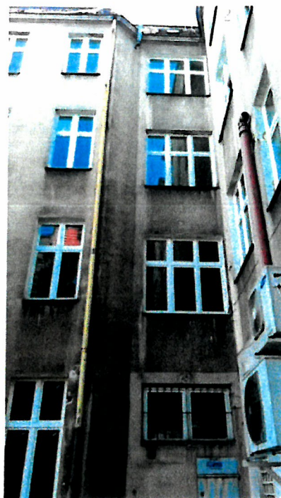
Rys. 11 Fragment elewacji północnej (wewnętrznej) z wymienionymi oknami PVC przed wykonaniem remontu elewacji kamienicy, źródło własne
