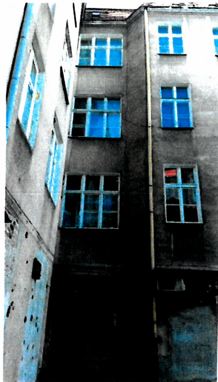
Rys. 7 Fragment elewacji tylnej z widocznymi pęknięciami na elewacji oraz stolarką okienną, źródło własne
